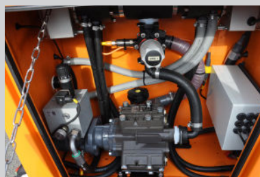
Ein leicht zugänglicher Maschinenraum schützt Hydraulik, Steuerung und Membranpumpe
